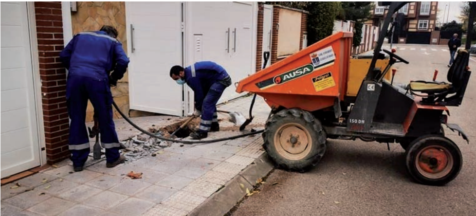
Imagen de archivo de una actuación por avería de agua
