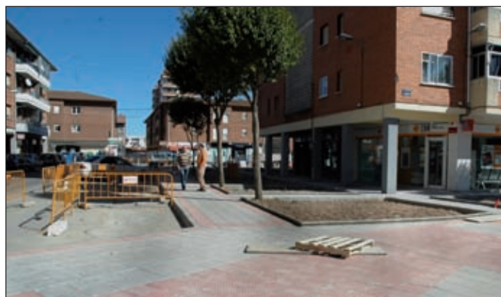
Imagen del estado actual de las obras en la Plaza de Castilla, en concreto, en la calle de Cuenca, donde ya ha comenzado la pavimentación de las aceras
