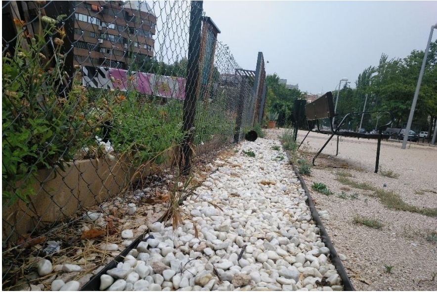
Figura 16: Dren filtrante en Madrid.
